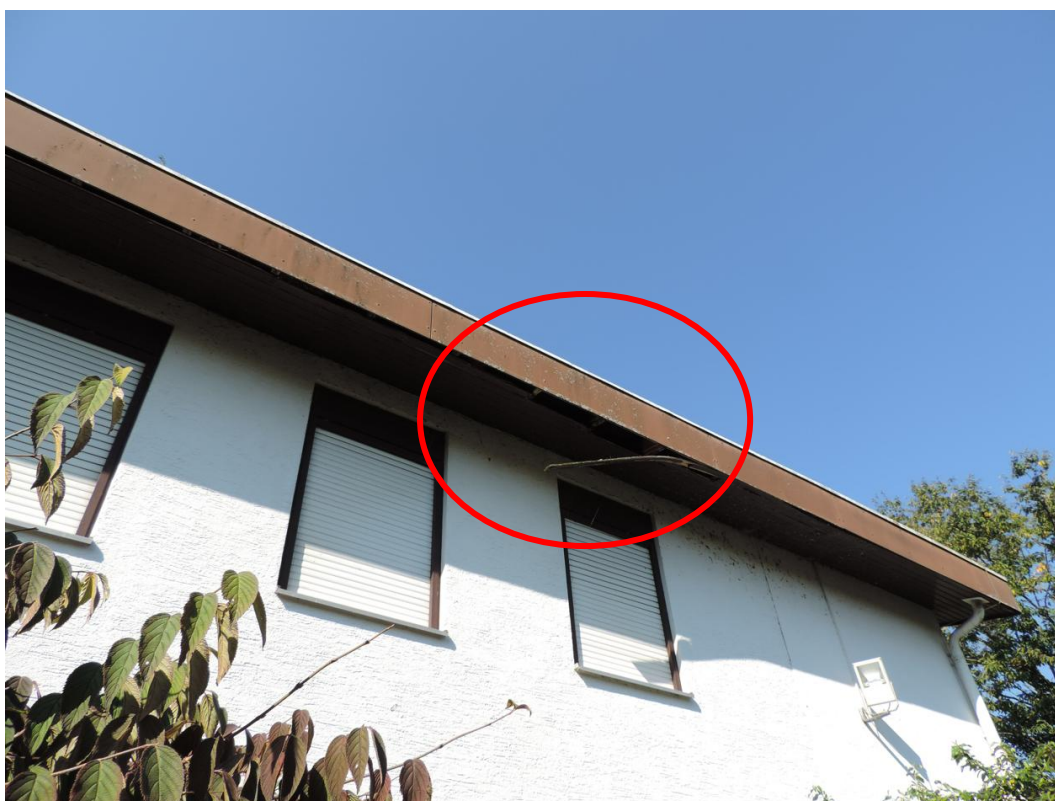
Bild 15: Weiter Spalte in der Holzverkleidung
